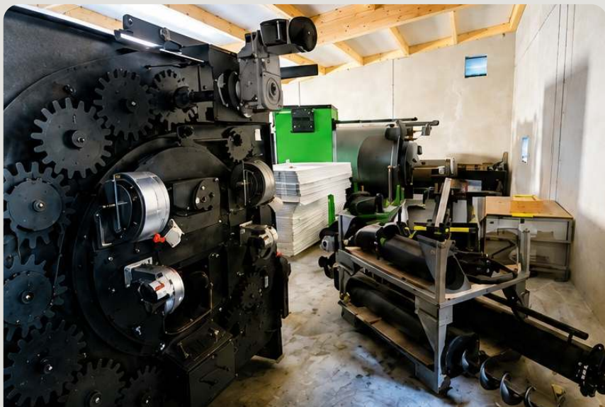
Ciepłownia RHK-AK 400 kW
